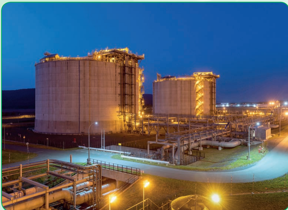
Резервуары для хранения СПГ. Производственный комплекс «Пригородное»
